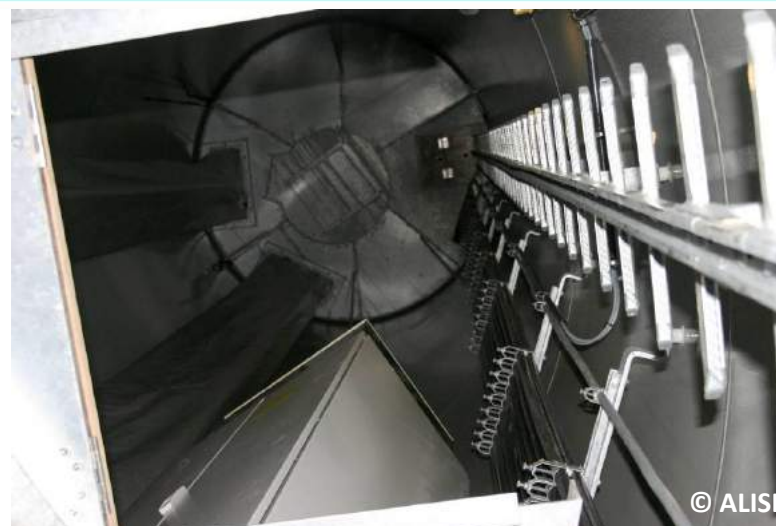
Photo 57 : Intérieur du mât d'une éolienne (échelle d'accès)
