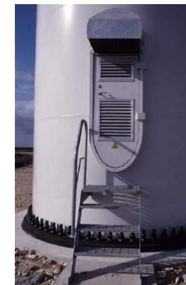
Photo 62 : Transformateur électrique intégré au mât de l'éolienne
