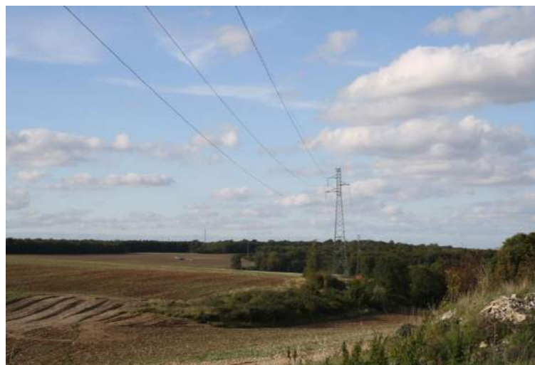
Photo 39 : Ligne RTE sur la Z.I.P.
